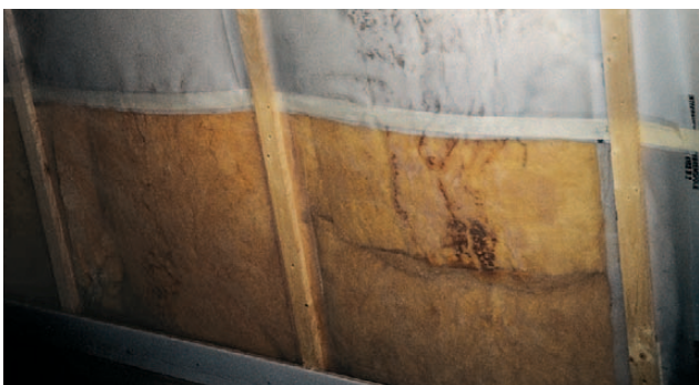
Poškození způsobené zabudováním vlhkého dřeva
