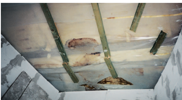
Poškození způsobené zkondenzovanou vodou
